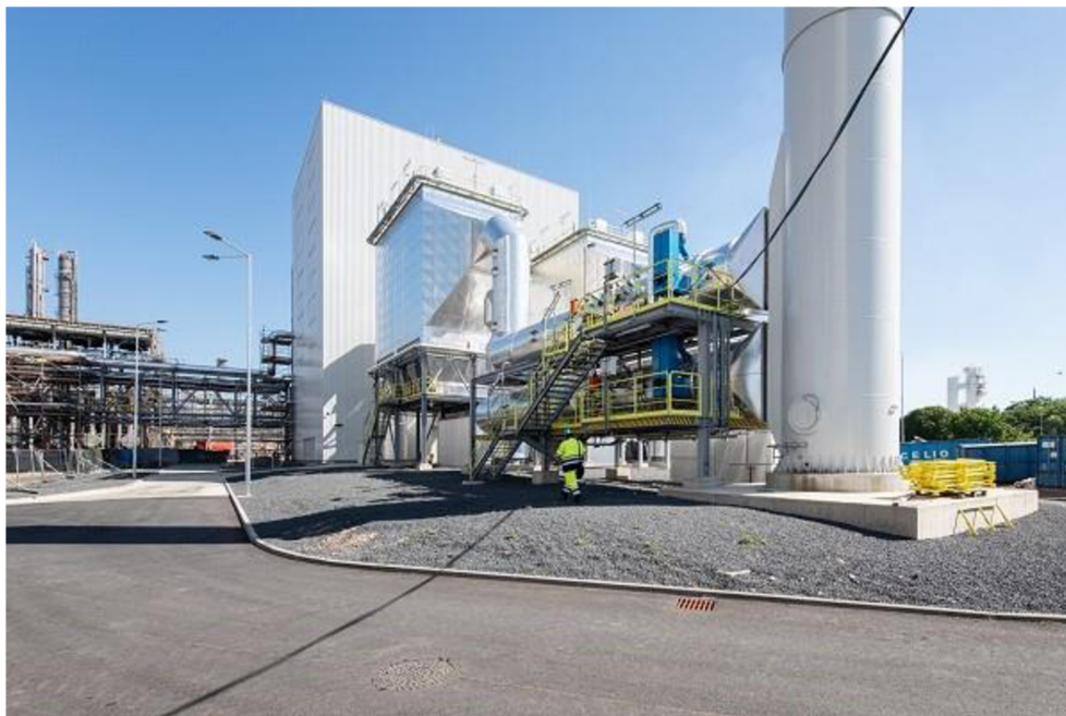
Obr. 4 – Teplárna vybavena plynovými kotli (zdroj: Unipetrol)
