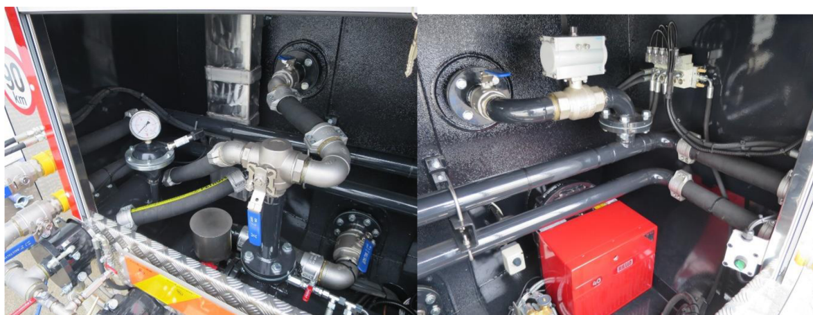
Obr. 2.9 a 2.10 Pohled do „uzavřené“ technologie na rozvody emulze
