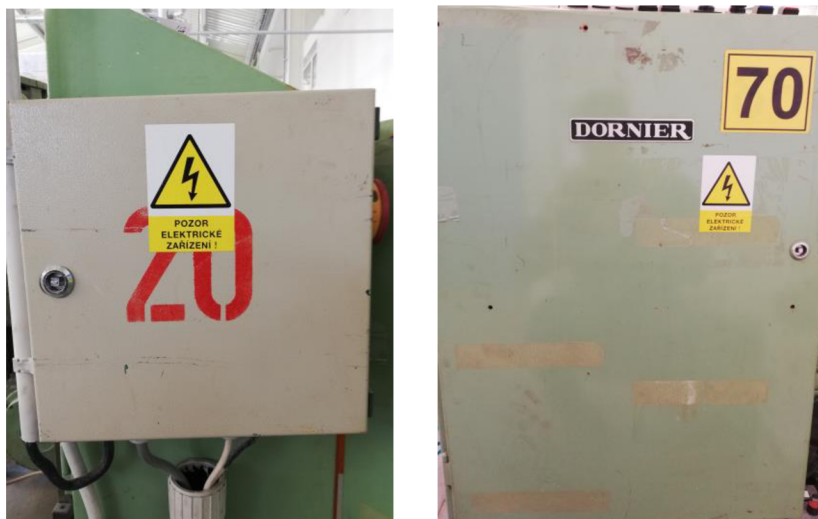
4.15 Příklady bezpečnostních tabulek upozorňujících před nebezpečím úrazu elektrickým proudem
