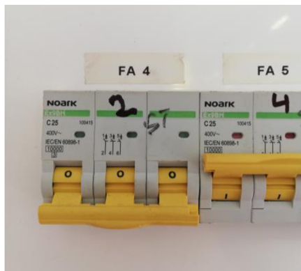
5.1 Znázornění vypnutého jističe v místním rozváděči
