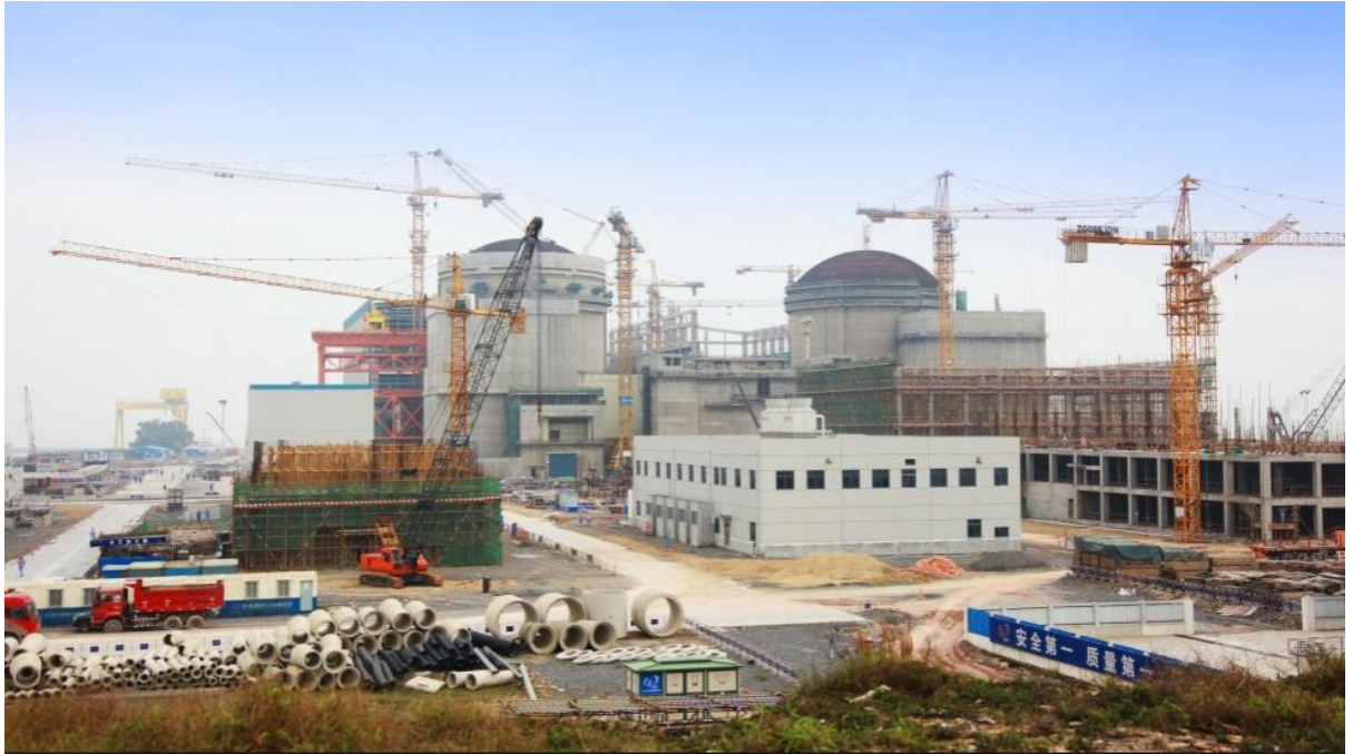
Figure 17: Najmodernejšia čínska atómová elektrárň [20]
