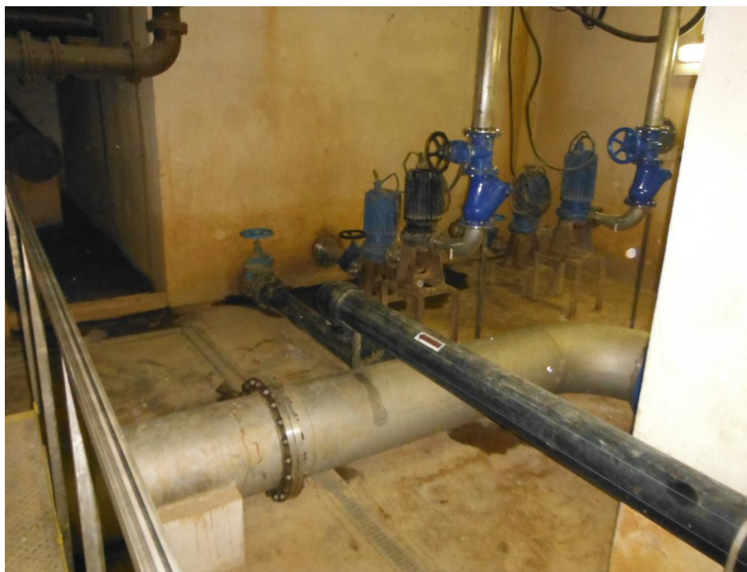
Obr. 4.8 Odkalovací potrubí (za stěnou je sací jímka kalů) na ÚV Ostrava Nová Ves [zdroj: Ilona Ševčíková]
