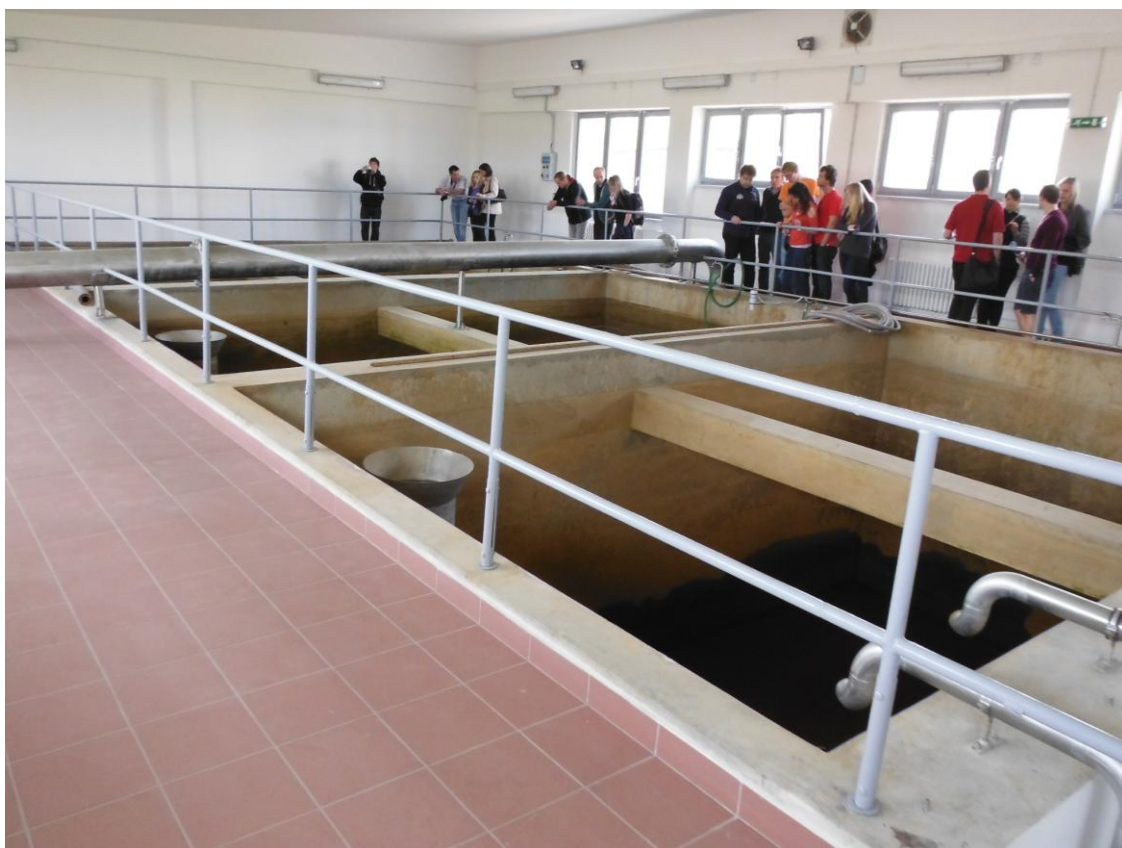
Obr. 4.31 Odsazovací nádrže na ÚV Kroměříž [zdroj: Ilona Ševčíková]
