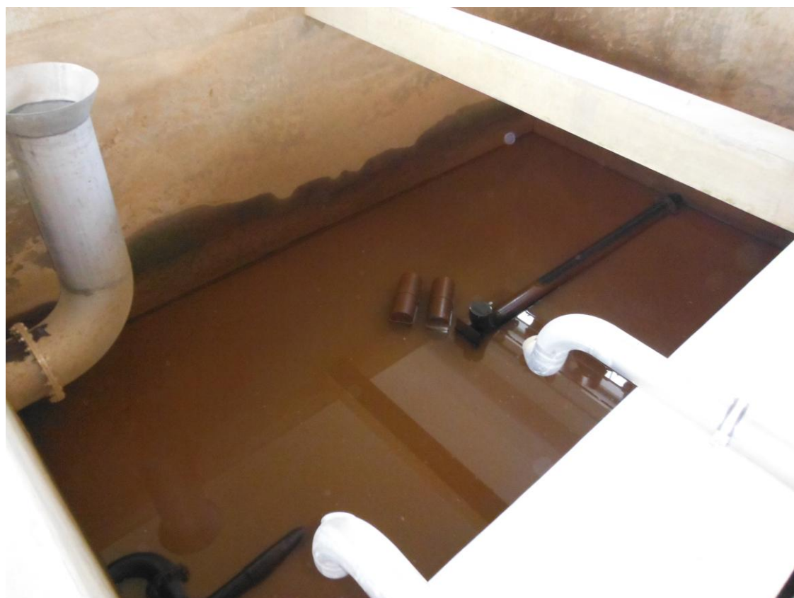
Obr. 4.32 Pohled do odsazovací nádrže na ÚV Kroměříž [zdroj: Ilona Ševčíková]
