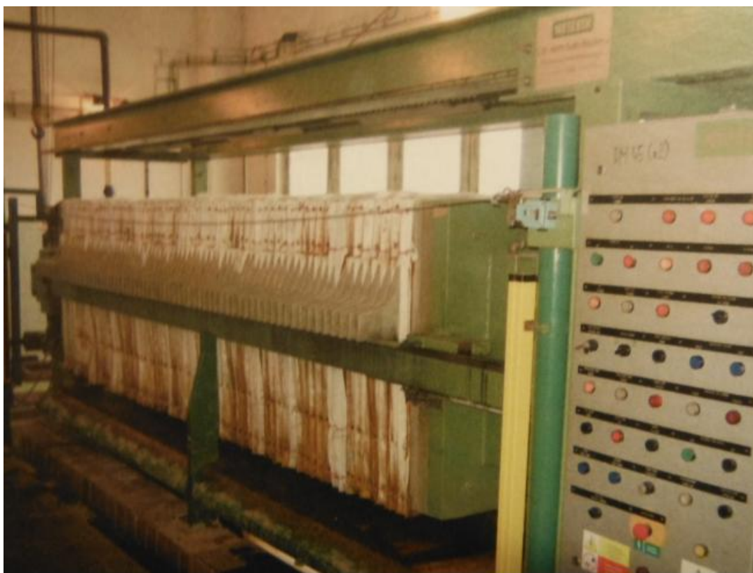
Obr. 3.10 Pohled na kalolis [1]
