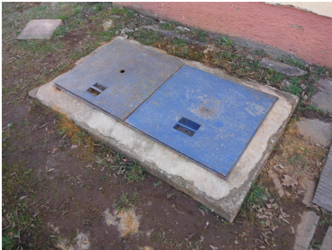
Obr. 4.9 Sací jímka kalů na ÚV Ostrava - Nová Ves [zdroj: Ilona Ševčíková]
