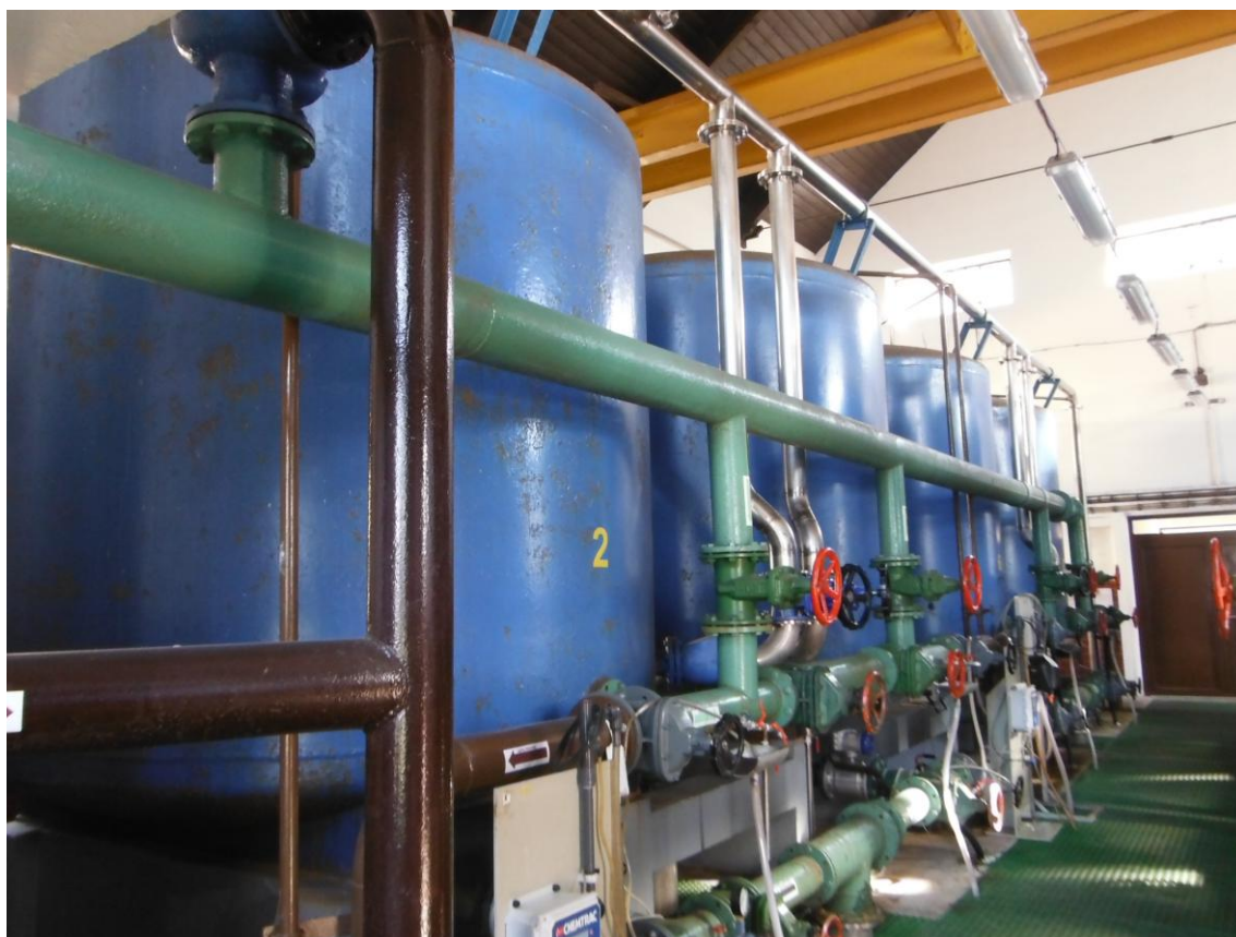
Obr. 4.5 Tlakové filtry na ÚV Ostrava - Nová Ves [zdroj: Ilona Ševčíková]
