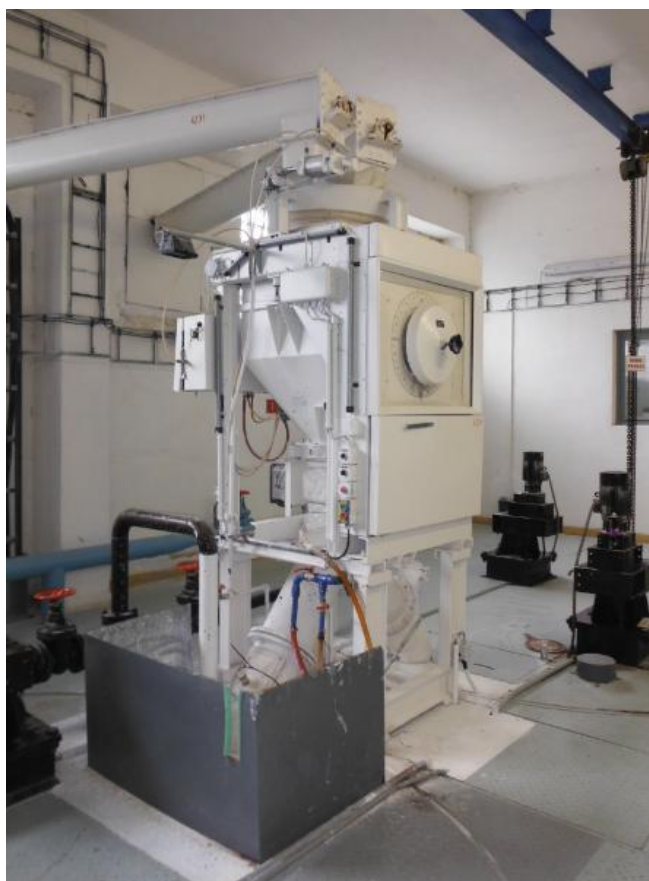
Obr. 4.19 Dávkování vápna před kalolisováním na ÚV Nová Ves u Frýdlantu [zdroj: Ilona Ševčíková]
