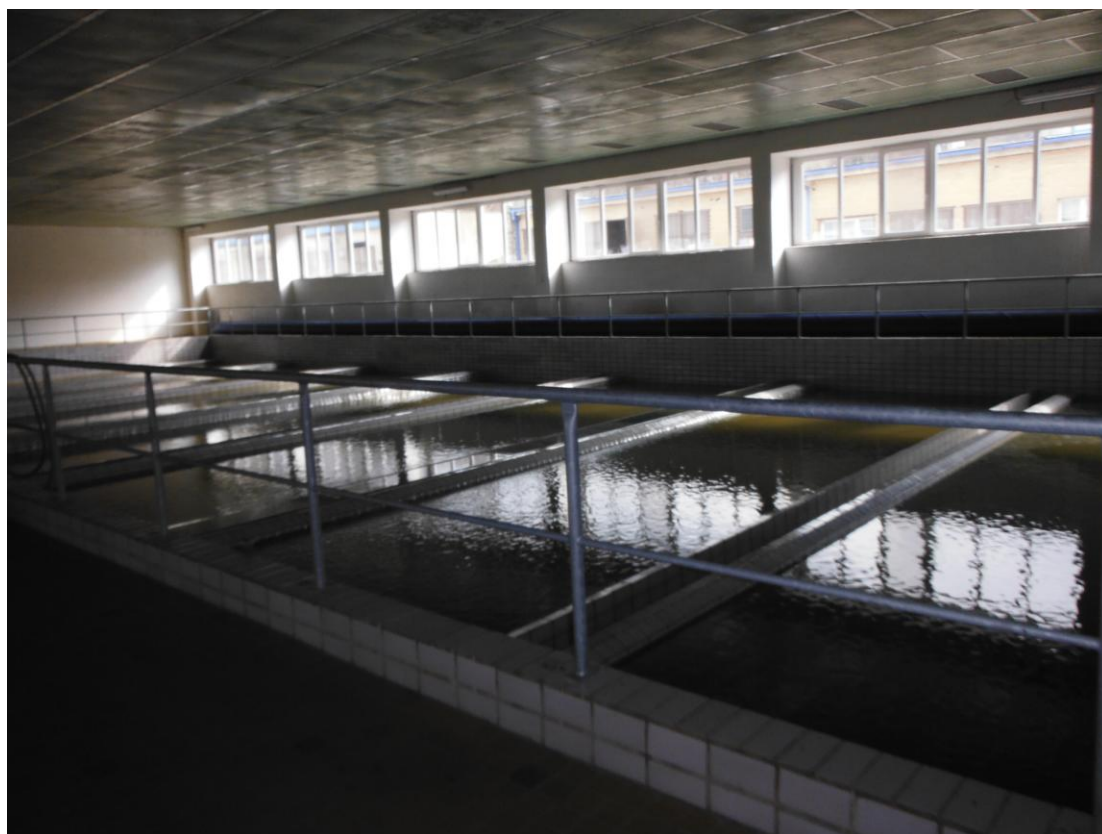
Obr. 4.17 Otevřené rychlofiltry na ÚV Nová Ves u Frýdlantu [zdroj: Ilona Ševčíková]
