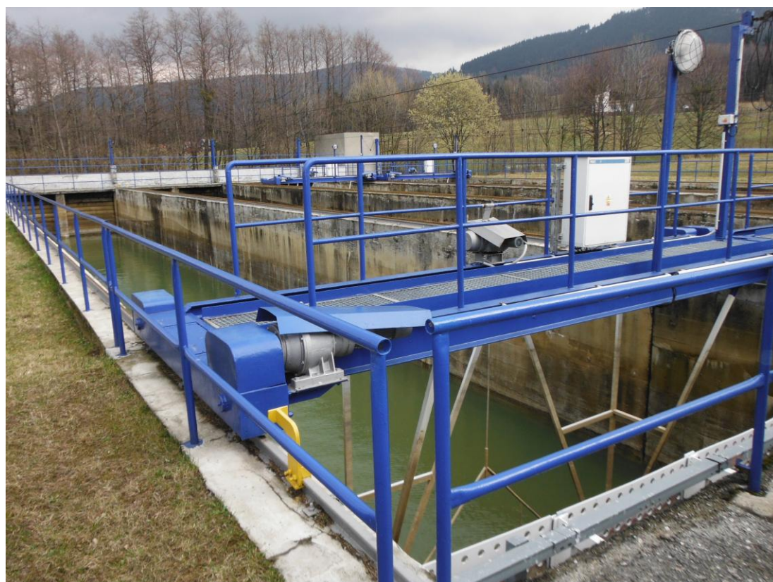
Obr. 4.18 Pravoúhlá usazovací nádrž (na vodu z praní filtrů) na ÚV Nová Ves u Frýdlantu [zdroj: Ilona Ševčíková]
