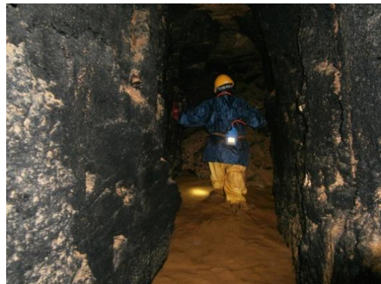
Obr. č. 19 Zavalená část štoly
