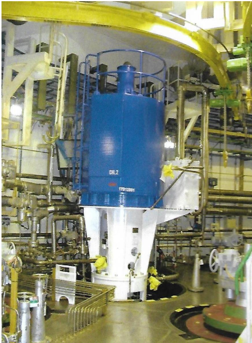
Obr. 3.1 Hlavní cirkulační čerpadlo JE Dukovany [14]
