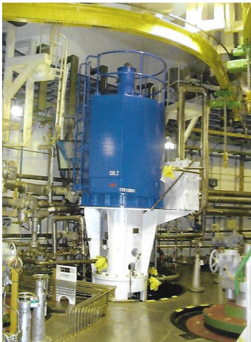
Obr. 3.1 Hlavní cirkulační čerpadlo JE Dukovany [14]
