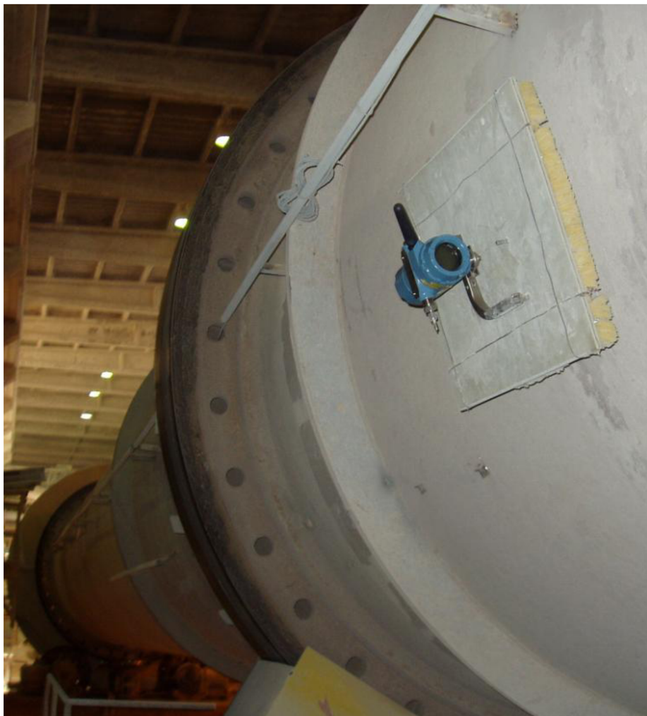
Obr. 20 Instalace WirelessHART převodníku 648W s označením TEPLOTA1 na rotační peci [4]
