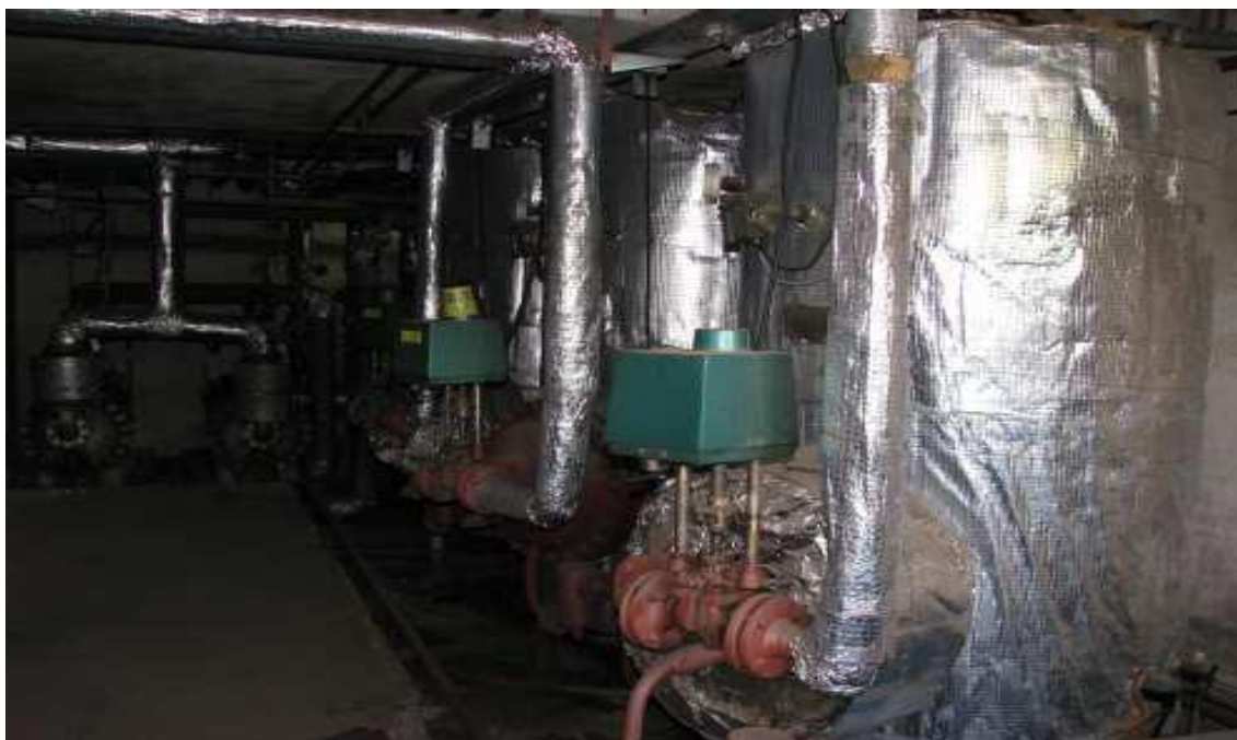
Obr. 7 Parní předávací stanice
