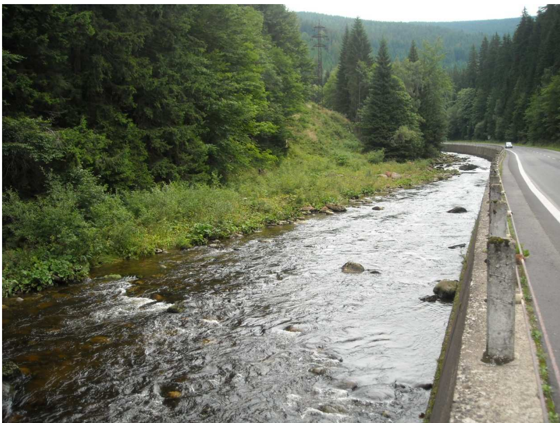
Obrázek č. 8 - Omezení úkrytové kapacity opěrnou zdí silnice (Labe). Foto: autor.
