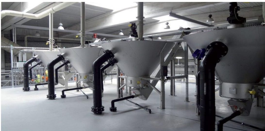
Obr. 6: Pračky písků v objektu hrubého předčištění (URL 4)
