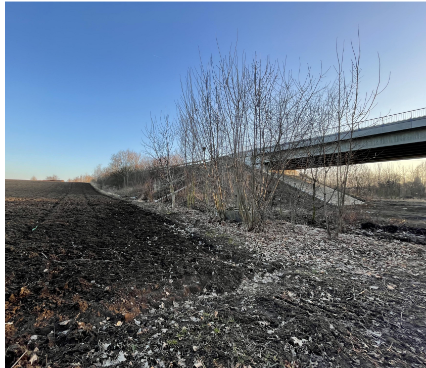
1. POHLED NA MOST A SILNICI I/38 SMĚREM NA ODSTAVNÉ PARKOVÁNÍ - LEVÝ OKRAJ
