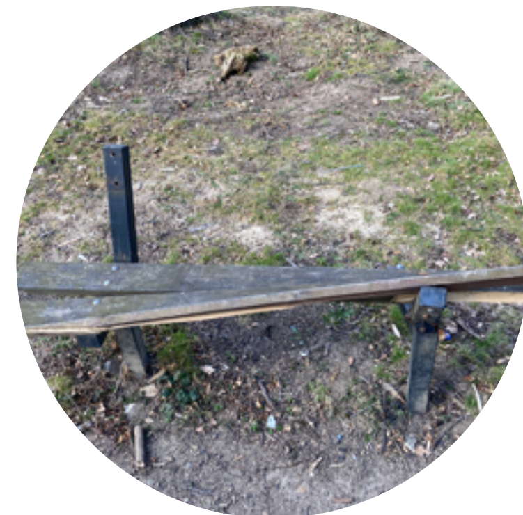
obr. 114 špatný stav mobiliářů
