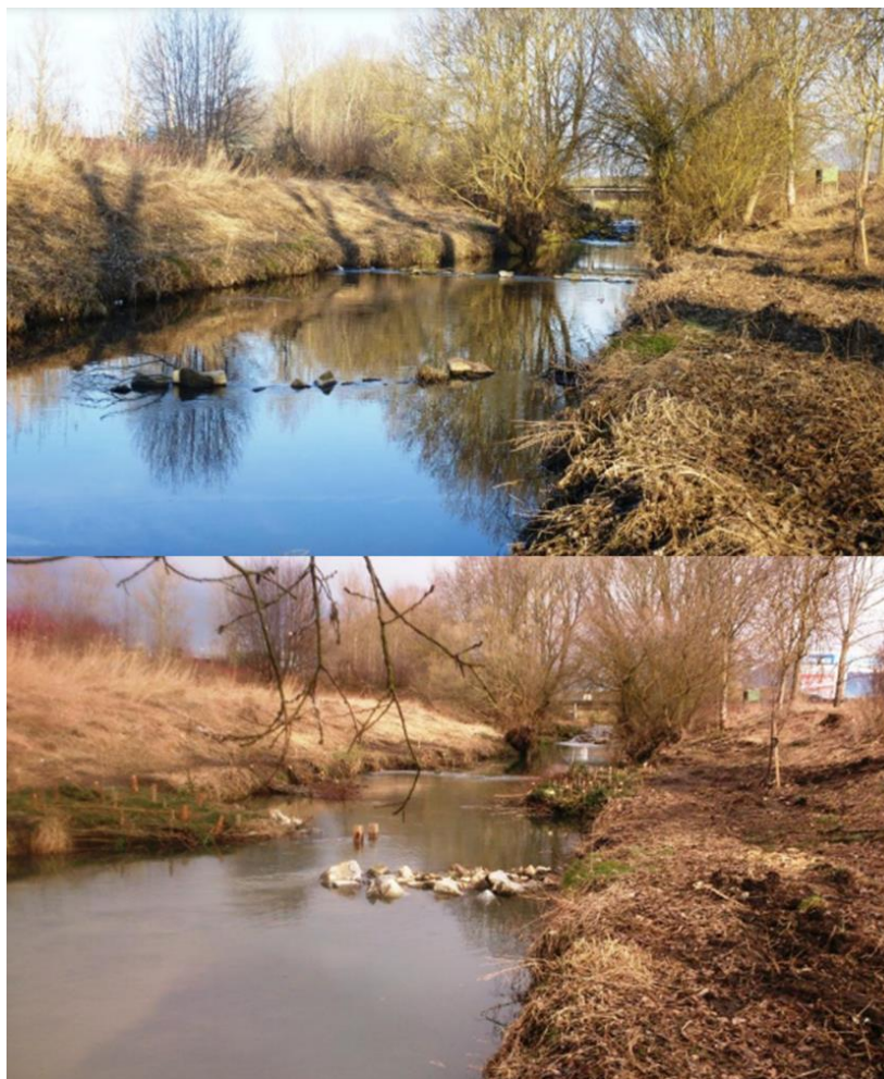
Obr. 71. Rovný úsek toku (nahore) a po provedeném opatření pomocí trojúhelníkových výhonů z fašín a kameniva (dole) (Schwippe Angler Dagersheim, 2015)
