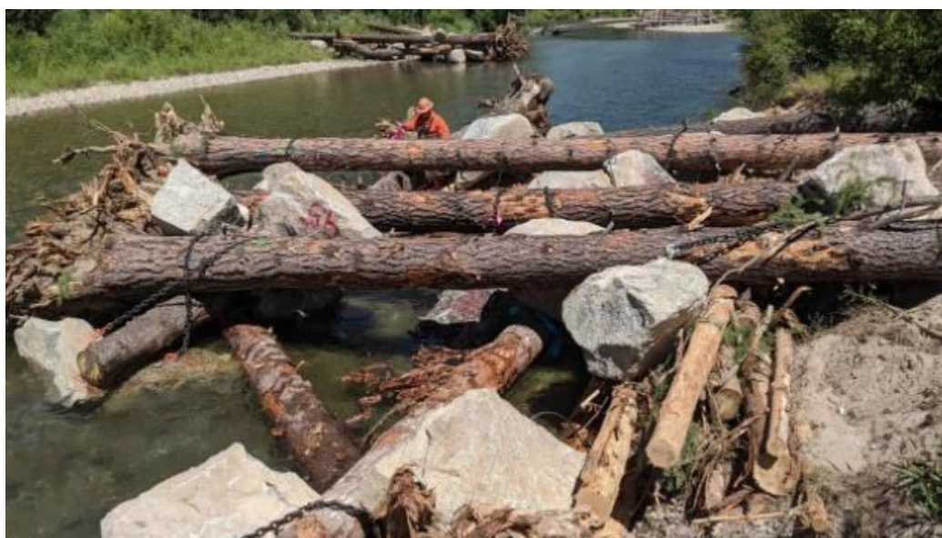
Obr. 46. Kmeny stromů upevněné řetězy a velkými balvany ke břehu (NDS, 2019)
