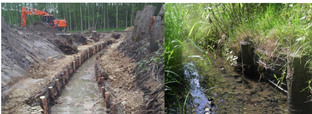
Obr. 112. – 113. Realizace břehového opatření pomocí kůlů a válců z proutí (vlevo) a (vpravo) již s vegetací, dřevo po čase podléhá hnilobě a tok se samovolně renaturuje (Lamberty, 2020)
