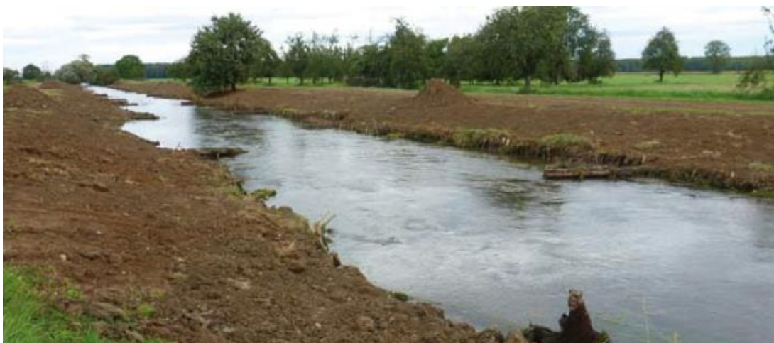
Obr. 22. Revitalizovaný úsek pomocí umístění kmenů střídavě do břehů krátce po rekonstrukci (Jany, 2013)
