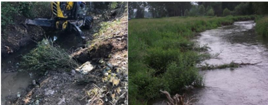
Obr. 59. – 60. Instalace haťových válců do břehu (vlevo) a již dokončené opatření (vpravo) (DBVU, 2020)
