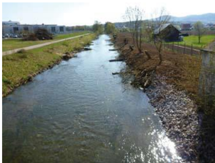
Obr. 19. Rovný tok ve fázi výstavby, úpravy levého břehu dokončeny a pravý břeh ve fázi příprav (Jany, 2013)
