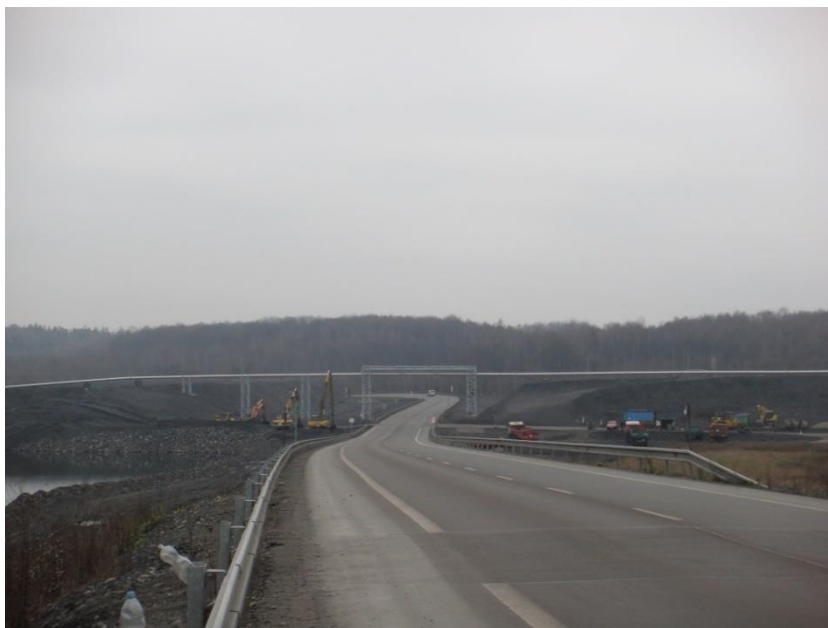
Obrázek 43: Trasa 1: Probíhající stavební práce s těžkou technikou v blízkosti lokality Louky – „Osmá stavba“ (foto autor)
