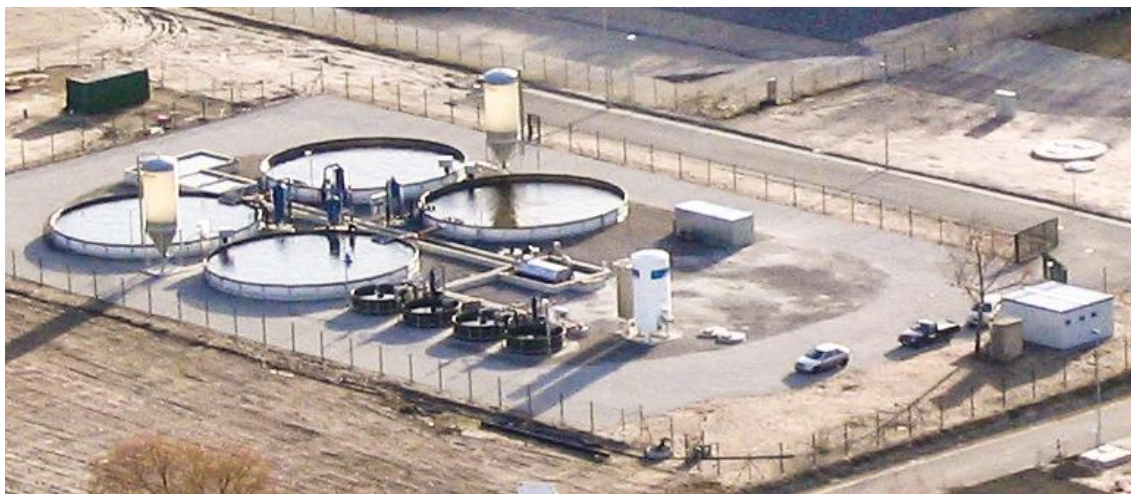
Obr. č. 3. Odchovný průtočný systém s odpadní oteplenou vodou, Schwarze Pumpe Německo (Rümmeler a kol., 2011)
