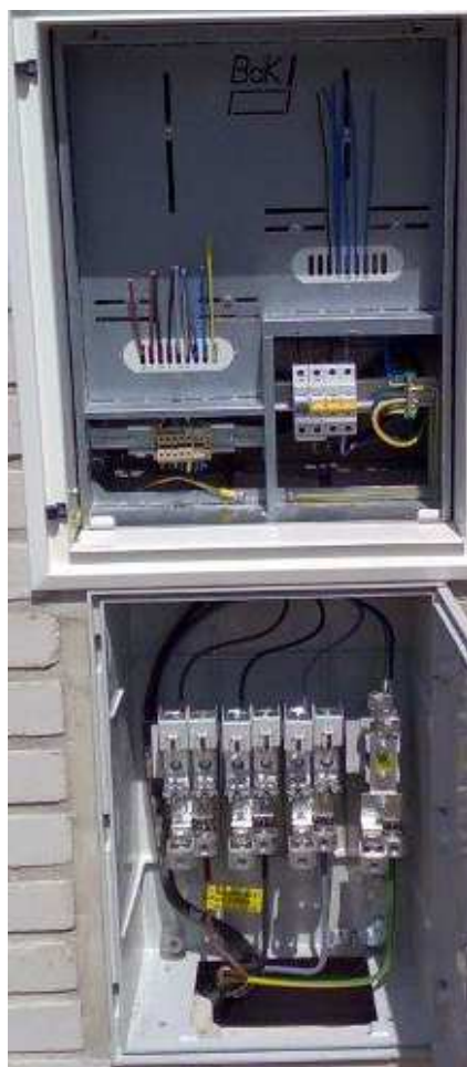
Obrázek 4-2: Hlavní domovní kabelová skříň s elektroměrovým rozváděčem [9]
