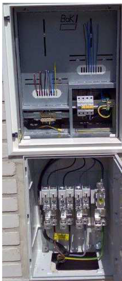
Obrázek 4-2: Hlavní domovní kabelová skříň s elektroměrovým rozváděčem [9]
