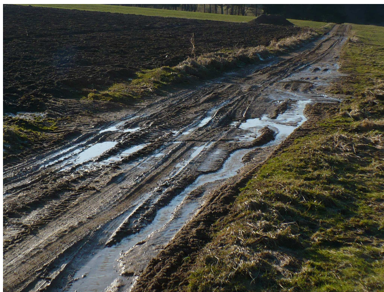
Foto č.4: Silně zanesená komunikace HC2 (autor)
