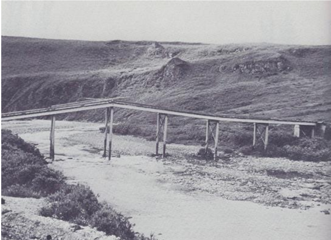
Obrázek 23 - Mrazem vytlačené ocelové pilíře mostu na Kougarok Highway přemostující řeku North Fork (Ferrians, et al., 1969)
