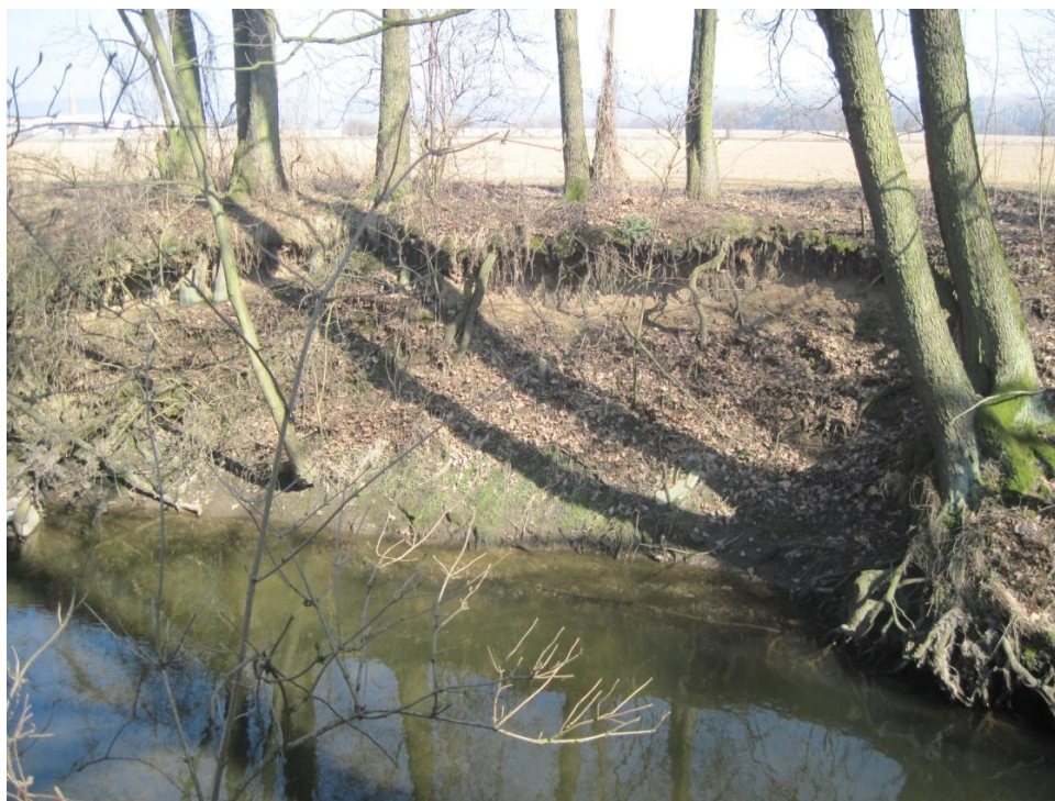
Obr. č. 11: Břehová nátrž řeky Oskavy u společnosti Tekro, s.r.o. (Pavlíková, 3/2015)
