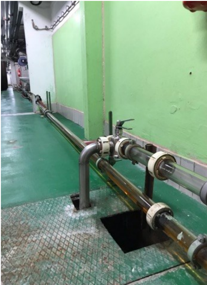
Obr. 2.4: Potrubí užívané k přepravování lihu
