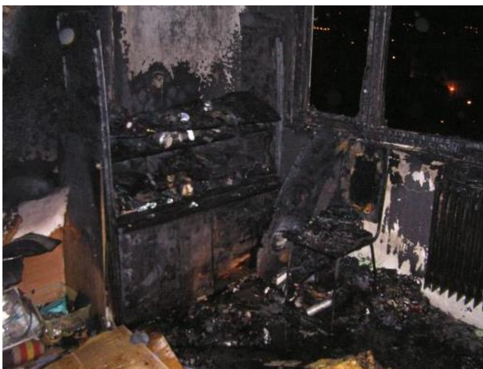
Obrázek č. 8: Požár panelového domu 3.8.2008
