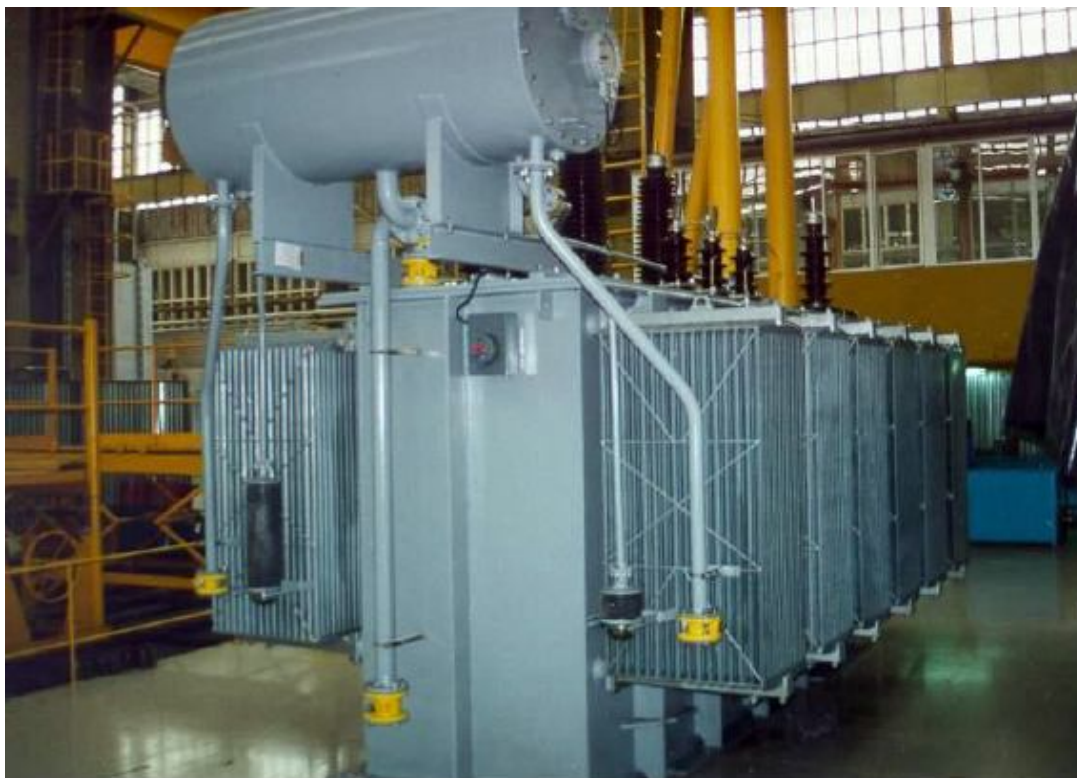
Obrázek 1. Výkonový olejoý transformátor
