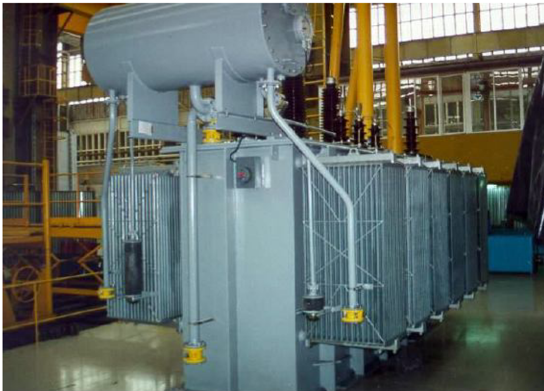
Obrázek 1. Výkonový olejoý transformátor
