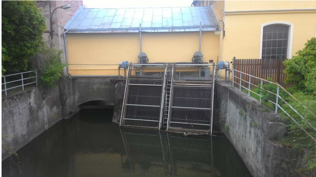
Obr. 8: Vodní elektrárna ve Veselí nad Moravou. (Zdroj: Vlastní foto)
