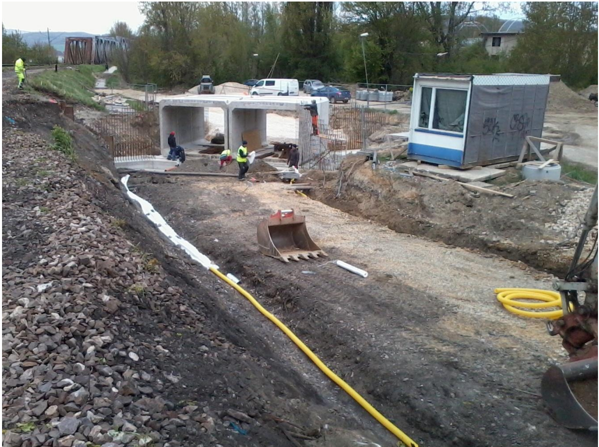
Obrázok 7-14: Drenáž na odvodnenie podchodu [autor]
