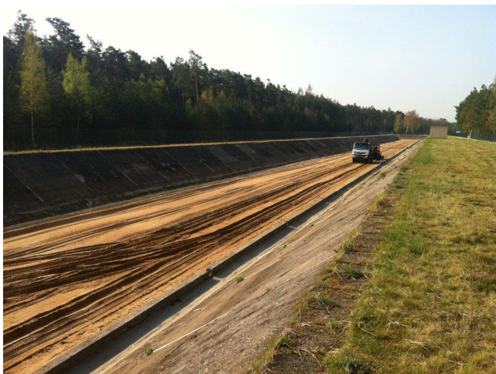
Obrázek 12: Umělá infiltrace Kárané, odstraňování horní vrstvy filtrátu (Vodárna Káraný a.s., © 2020)
