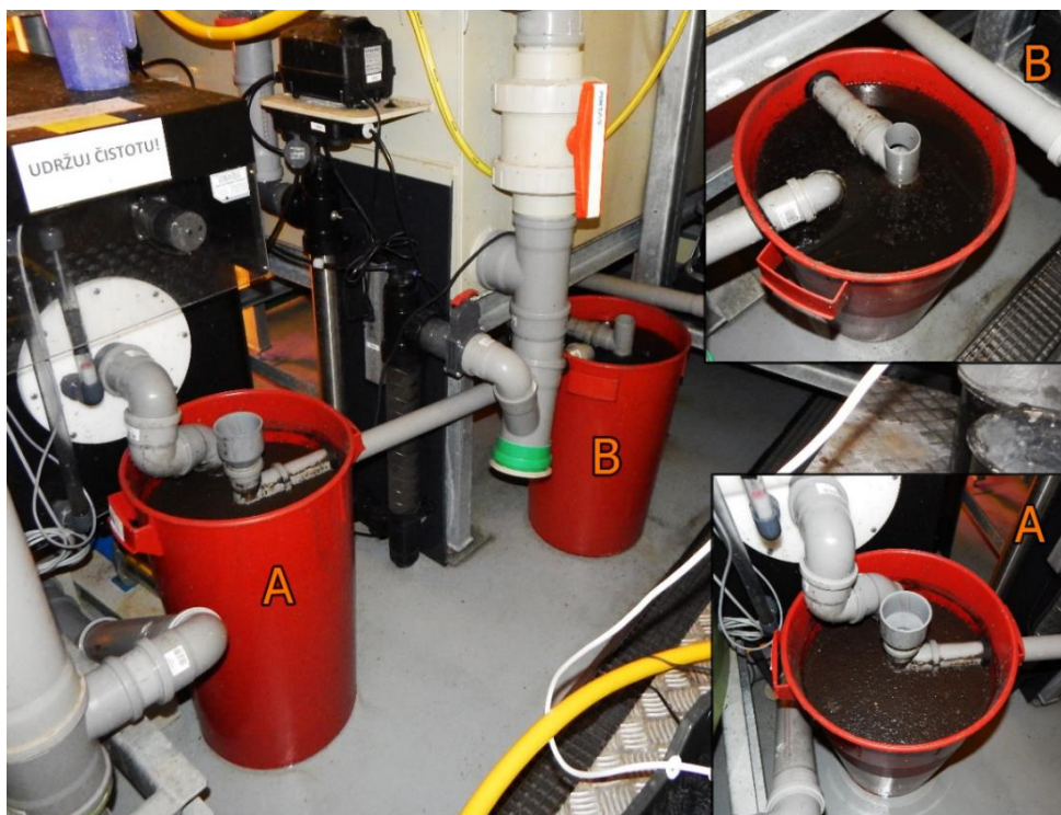
Obrázok 5: Nádrž k separácii nerozpustených látok (A) a k akumulácii odpadovej vody (B) (foto: autor).
