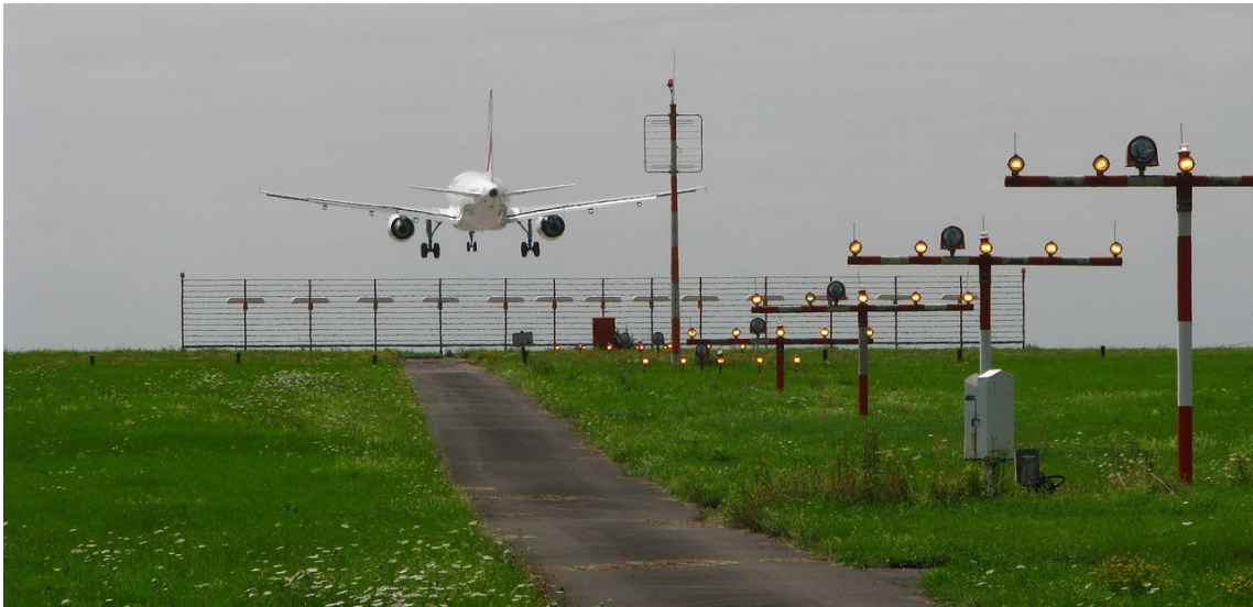
Obr. 1.3 ALS (Approach Light System)
