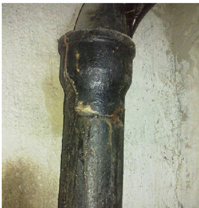
Obr. č. 10 - Litinové potrubí použité uvnitř budovy [13]
