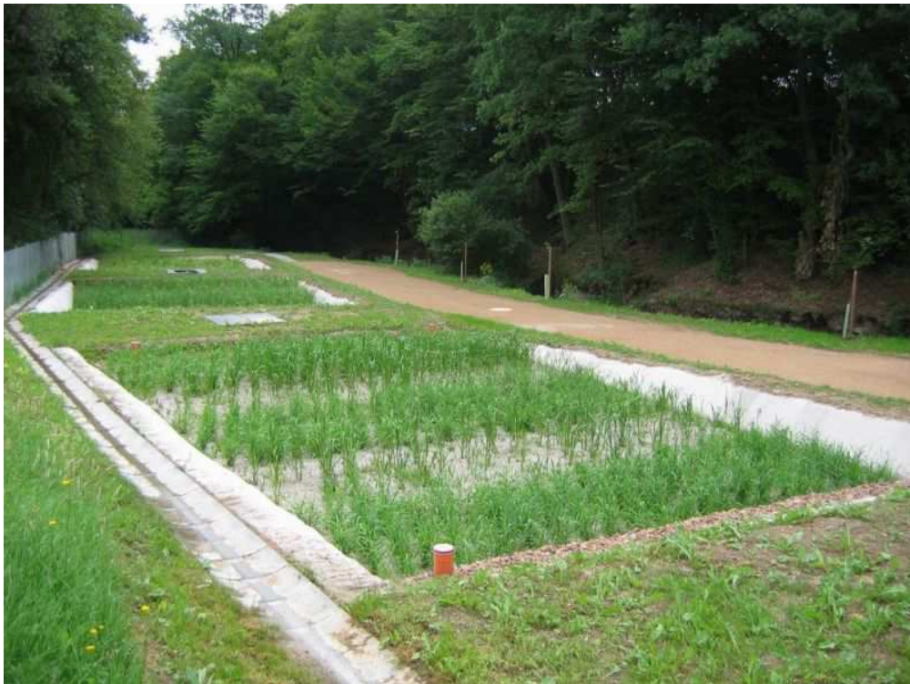
Obr. č. 27 - Kořenová čistírna odpadních vod [30]
