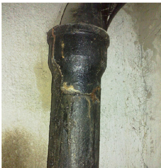
Obr. č. 10 - Litinové potrubí použité uvnitř budovy [13]
