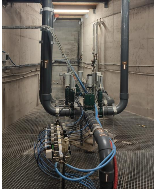
Obr. 4.4 Systém přečerpávání, umístěn mezi fermentorem a koncovými sklady; zdroj: fotografie autora
