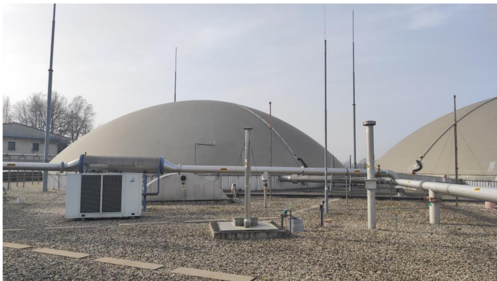
Obr. 4.5 Chlazení bioplynu, v pozadí KS1 a KS2; zdroj: fotografie autora
