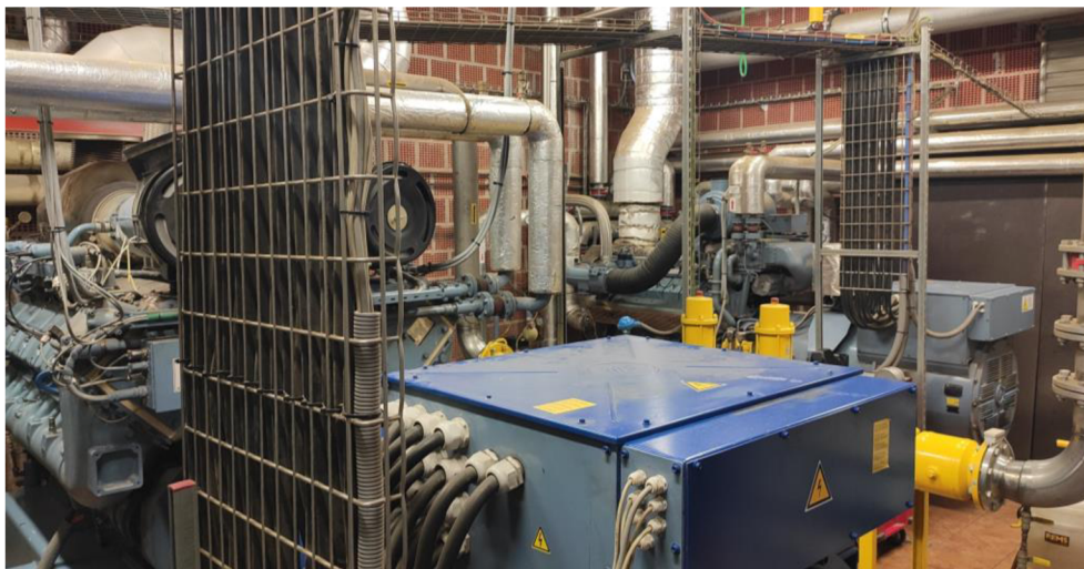
Obr. 4.6 Motory MWM, společný maximálním výkonu 1750 kW; zdroj: fotografie autora
