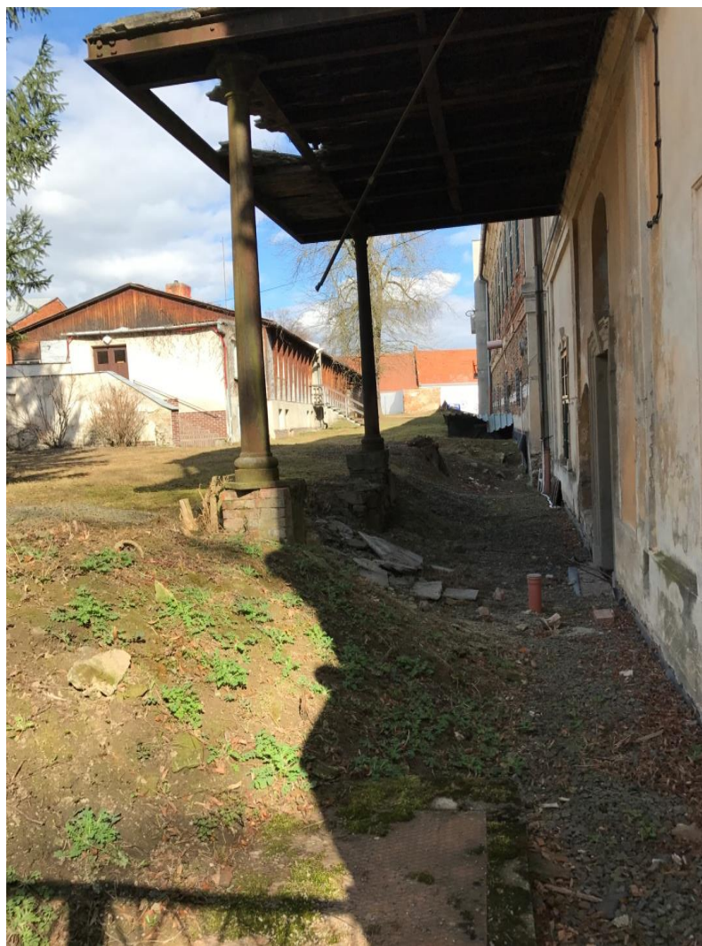
Foto 52: Zámek Výšovice – rozpadající se střecha
