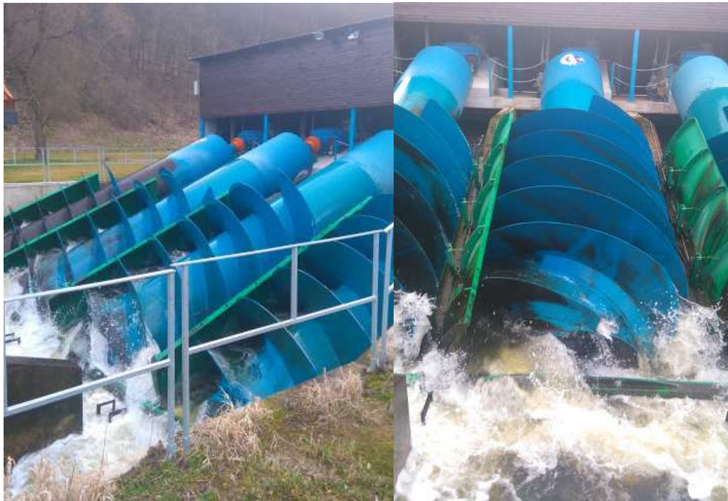
Obr. č. 31 a 32. – Pohled na činnost turbín na MVE Kaceřovský mlýn (vlastní fotografie)
