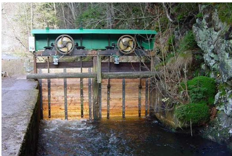
Obr. č. 13. – Příklad řešení stavidlových uzávěrů na MVE Špindlerův Mlýn na řece Labe ( http://1-labska.cz/mala-vodni-elektrarna )
