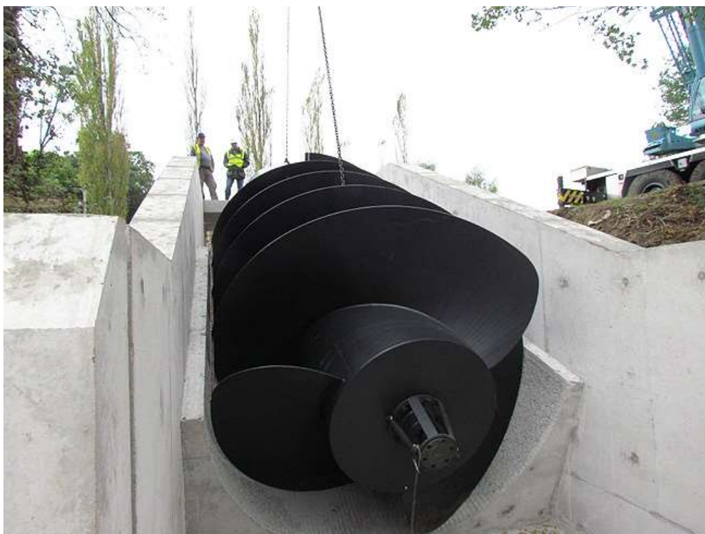
Obr. č. 26. – Příklad Archimédovy turbíny s betonovým žlabem
