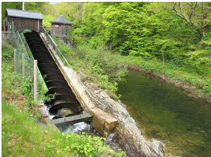
Obr. č. 22. – Příklad realizace malé vodní elektrárny v Dartmoor National Park ( http://www.emersonindustrial.com/enUS/controltechniques/newsandevents/presscenter/pressreleases/Pages/ArchimedesScrewPowersRiverDartCountryPark.asp )
