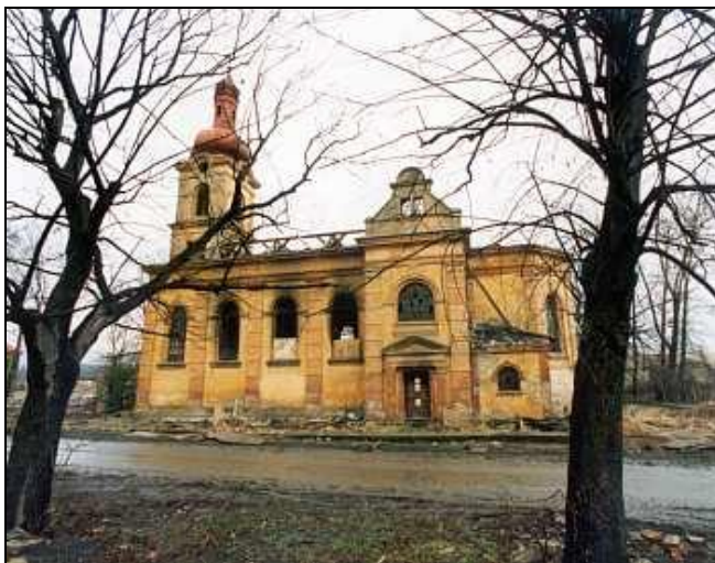
Libkovický kostel sv. Michaela v roce 1994, na snímku je vidět celkové chátrání a zdevastovaná střecha
