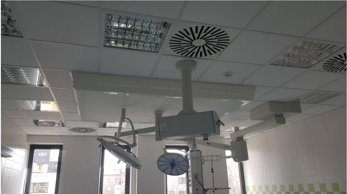
Obr. 9 Kombinovaný laminární strop v zákrokovém sále [23]
