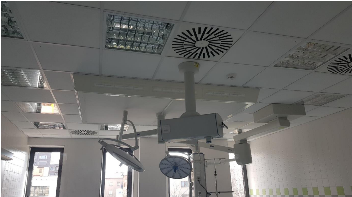
Obr. 9 Kombinovaný laminární strop v zákrokovém sále [23]
