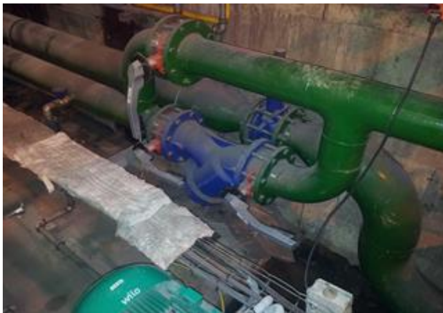
Obr. 10 Filtrová sestava čerpadla č. 1 chladicí věže
