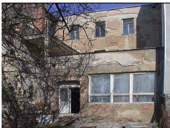
Obr. 3.3: Zadní fasáda před rekonstrukcí [30]
