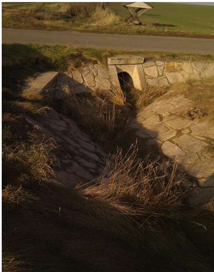
Obr. 2: Propustek pod cestou B2 (někdy značená C5/1) z pohledu od C2/2 SP-C162 (vlevo propustek pod cestou C2/2 do příkopu cesty B2) (Autor: V. Prášek, 2011)
