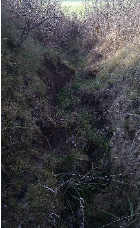
Obr. 9: Detail erozní rýhy v příkopu ve strži mezi 3. a 4. propustkem (Autor: Václav Prášek)
