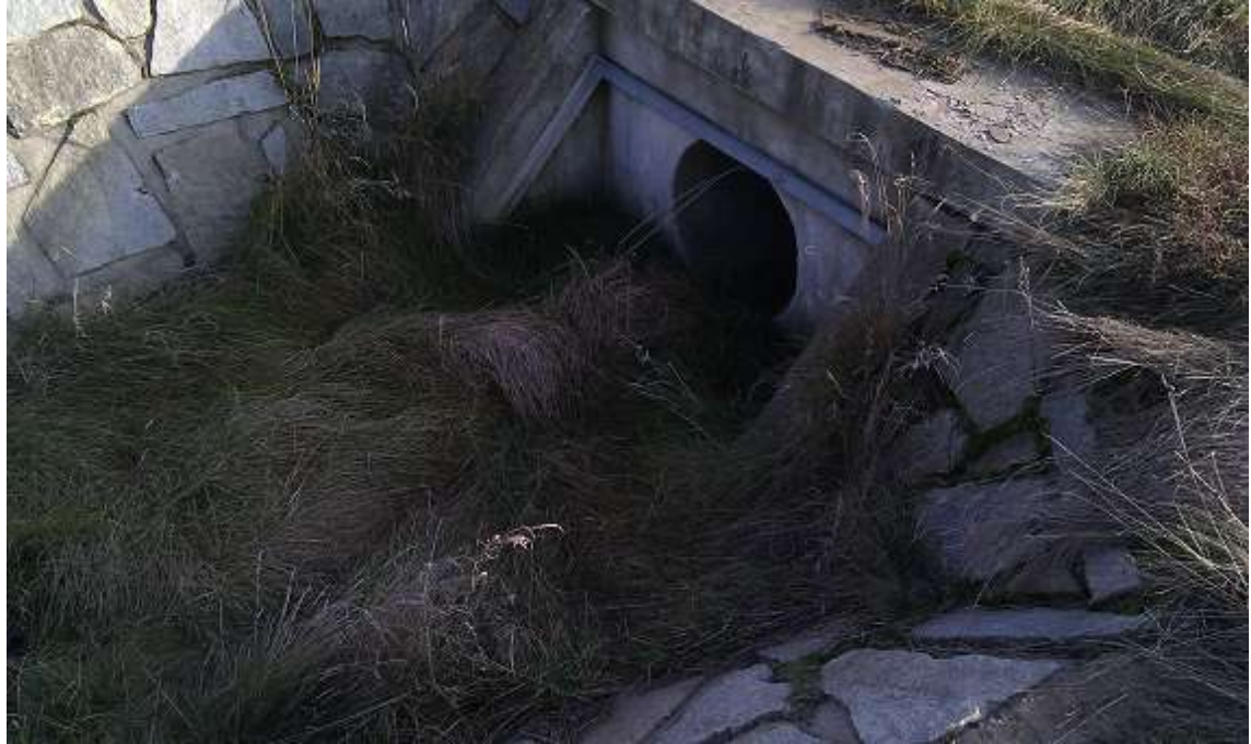
Obr. 6: Detail zaústění C2/1 SP-C162 do propustku pod cestou B2 (Autor: V. Prášek, 2011)
