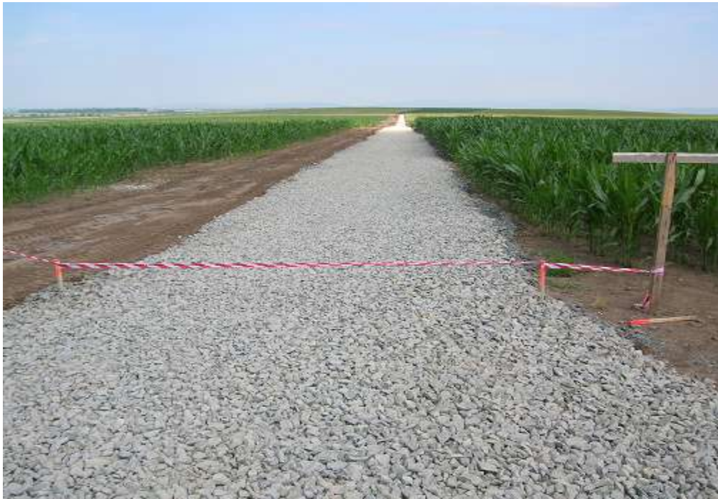
Obr. č. 14: Makadam před penetrací na C3 ZP1- Vojnice (Autor: J. Zbirovský, 2007)
