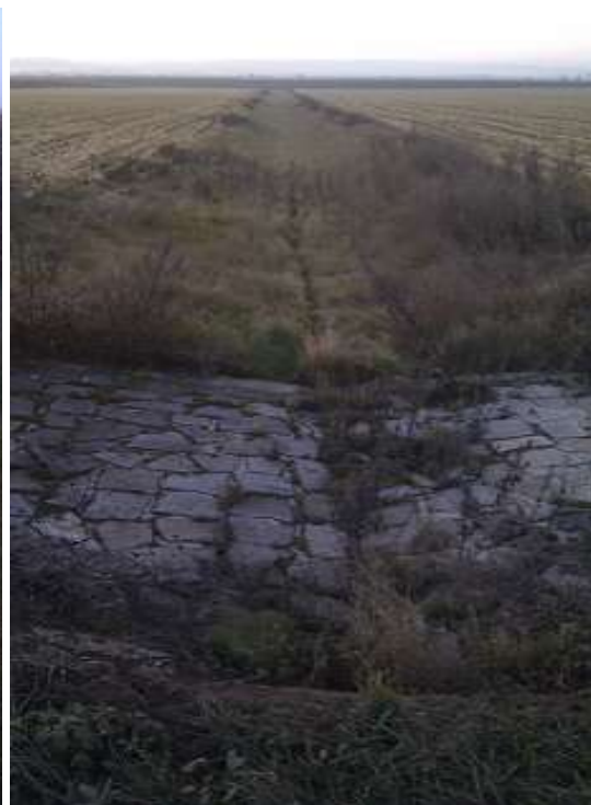
Obr. č. 26: Začátek SP1/3 (Vojnice) z výpustě propustku pod silnicí III/48815 (Autor: V. Prášek, 2011)
