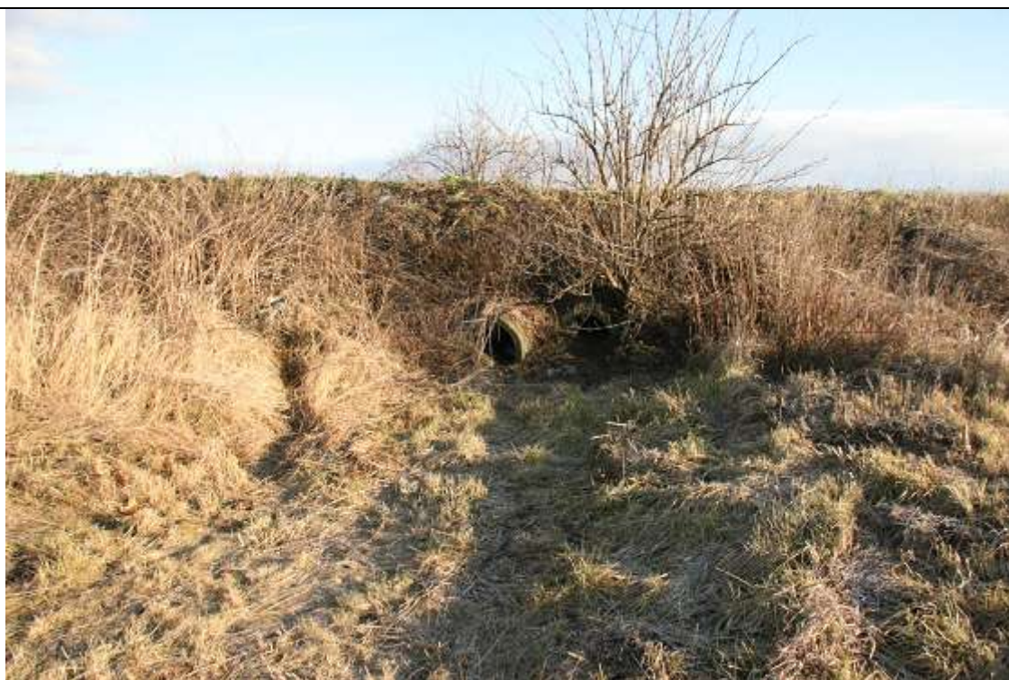
Obr. 3: Pohled na 2 výpustě do SP2 s BC pod silnicí III/44815 směr Senice na Hané (Autor: V. Prášek, 2011)
