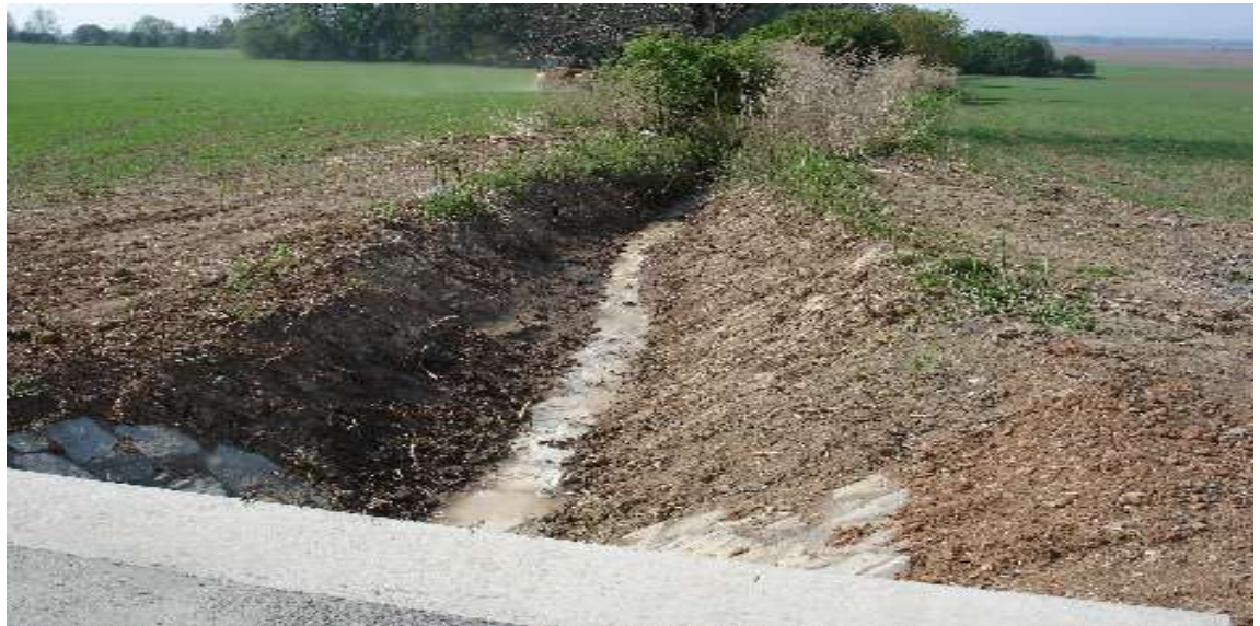
Obr. 3: Začátek příkopu z 1. trubního propustku silnice III/4491 po realizaci (Autor: Jan Zbirovský)
