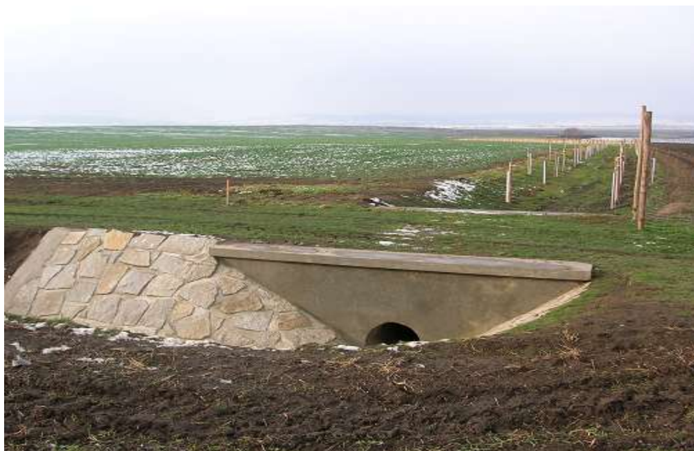
Obr. č. 20: Propustek pod C2/1 z průlehu SP-C162 (Vojnice) do průlehu C16 P3/30, v pozadí BC17 (Autor: J. Zbirovský, 2007)
