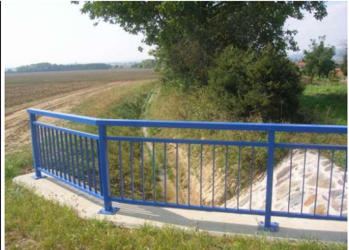
Obr. 3: Výpusť trubního propustku DN 1000/12,5 m z pohledu ze silnice III/4491 ze dne 18.09.2009 (Autor: Jan Zbirovský)
