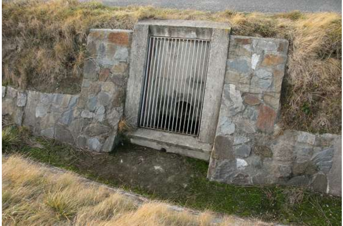
Obr. 5: Detail prvotní boční vpustě DN 300 s mříží pod C1 s napojením na stávající kontrolní šachtu (Autor: V. Prášek, 2011)
