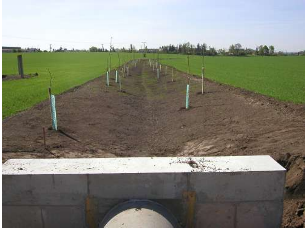
Obr. 4: Pohled na SP2 z cesty C4/2 směrem k začátku SP2 při výstavbě (Autor: Jan Zbirovský, 2003)
