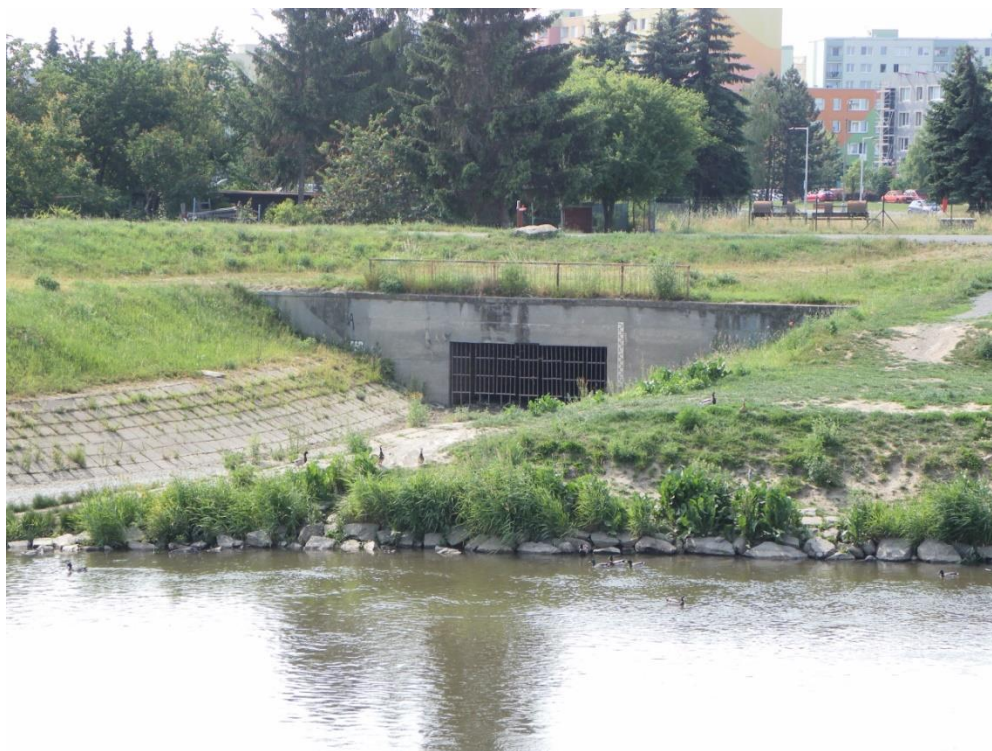
Obr. 21: Kanalizační sběrač na pravobřežní hrázi - Nové Sady. Zdroj: (Vlastní)
