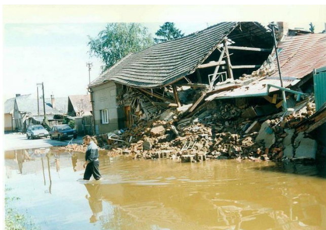
Obr. 12: Zdemolovaný rodinný dům v Černovíru. Zdroj: (Jindřichohradecký deník, 2010)
