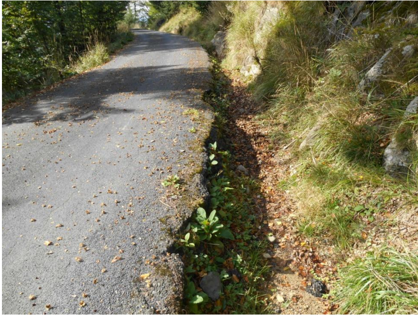
Obr.č.9: Lesní cesta Francouzská - Smrková před opravou (Vít Polák, 2014)
