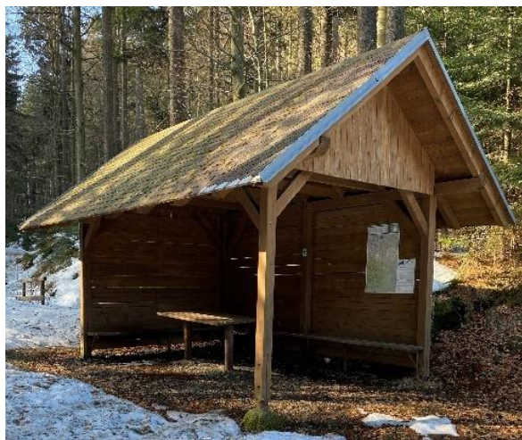
Obrázek 51 Odpočívadlo u rozcestí směrem k vodopádu, v dobrém stavu
