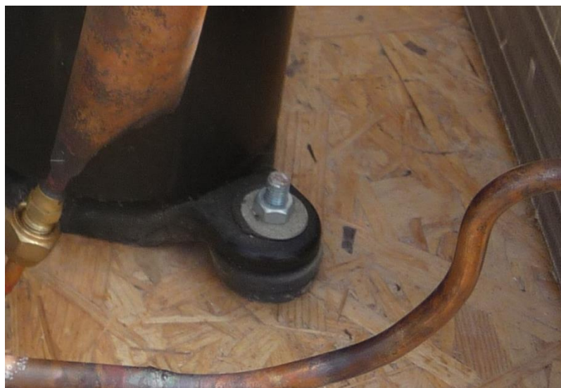
Obrázek č. 36 Silentbloky kompresoru (foto: Oliva)
