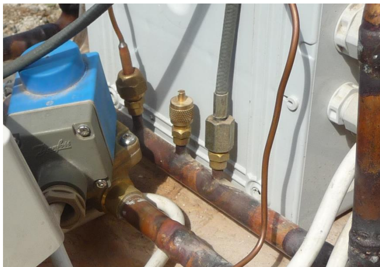
Obrázek č. 23 Servisní ventilkky na sací straně (foto: Oliva)
