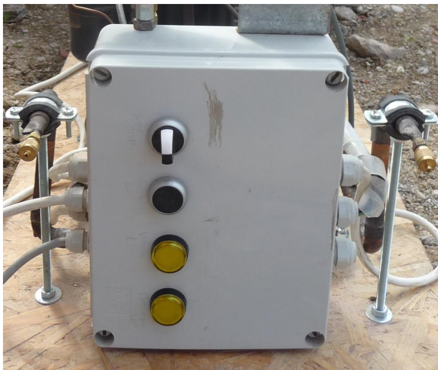
Obrázek č. 33 Elektrický rozvaděč, ovládací panel (foto: Oliva)
