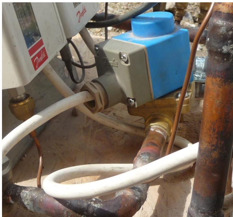
Obrázek č. 24 Elektromagnetický ventil Danfoss (foto: Oliva)
