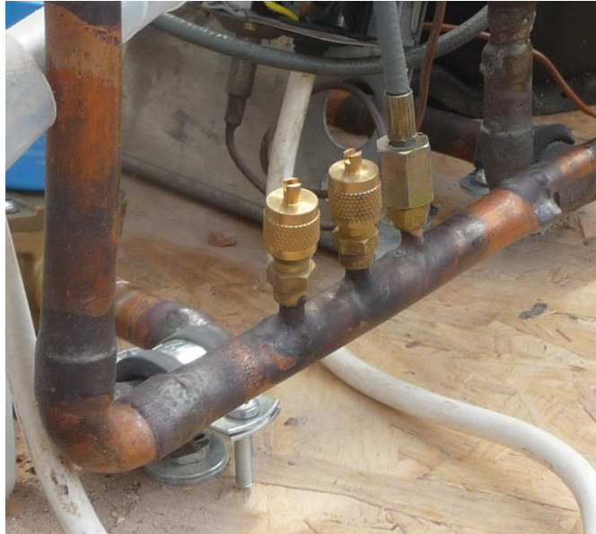
Obrázek č. 30 Trojice servisních ventilků před výstupem zařízení (foto: Oliva)
