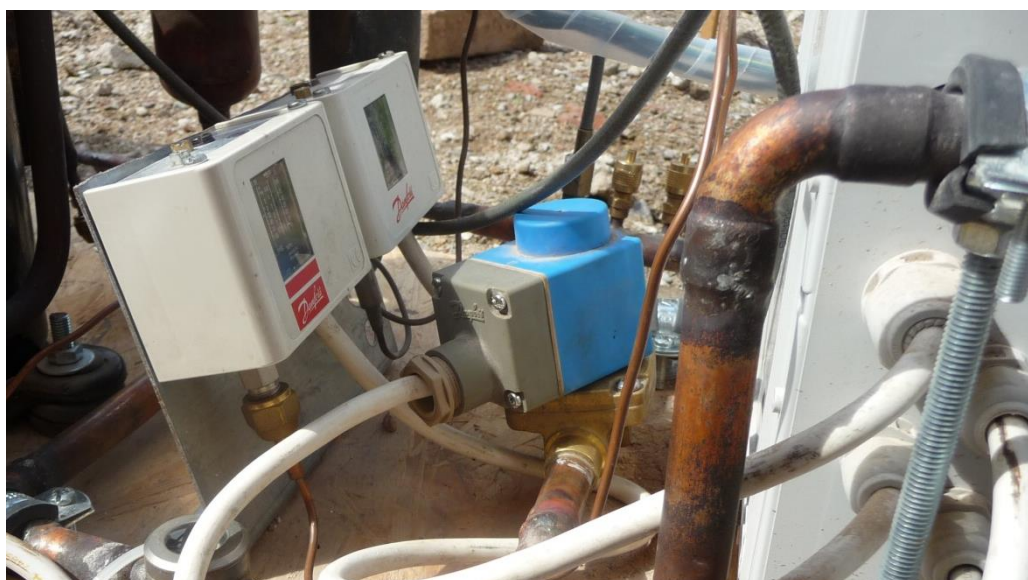
Obrázek č. 35 Umístění nízkotlakého a vysokotlakého presostatu (foto: Oliva)
