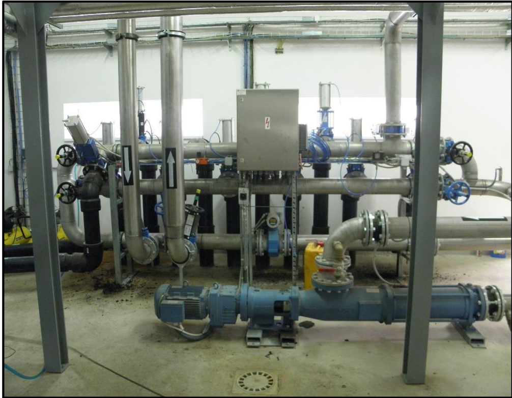
Obr. č. 21 – Čerpací centrum – srdce celé BPS (zdroj: Lucie Frank Kristová 29. 3. 2016)
