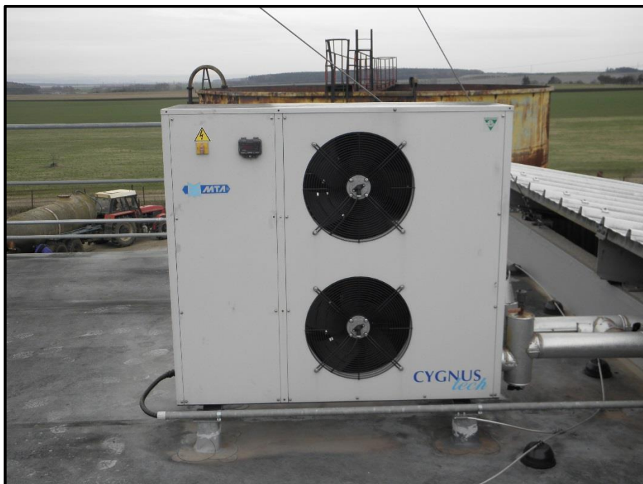
Obr. č. 26 – Klimatizační jednotka BPS (zdroj: Lucie Frank Kristová 29. 3. 2016)
