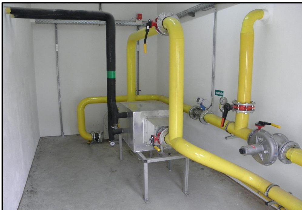
Obr. č. 20 – Úpravna plynu před vstupem do KGJ (zdroj: Lucie Frank Kristová 29. 3. 2016)
