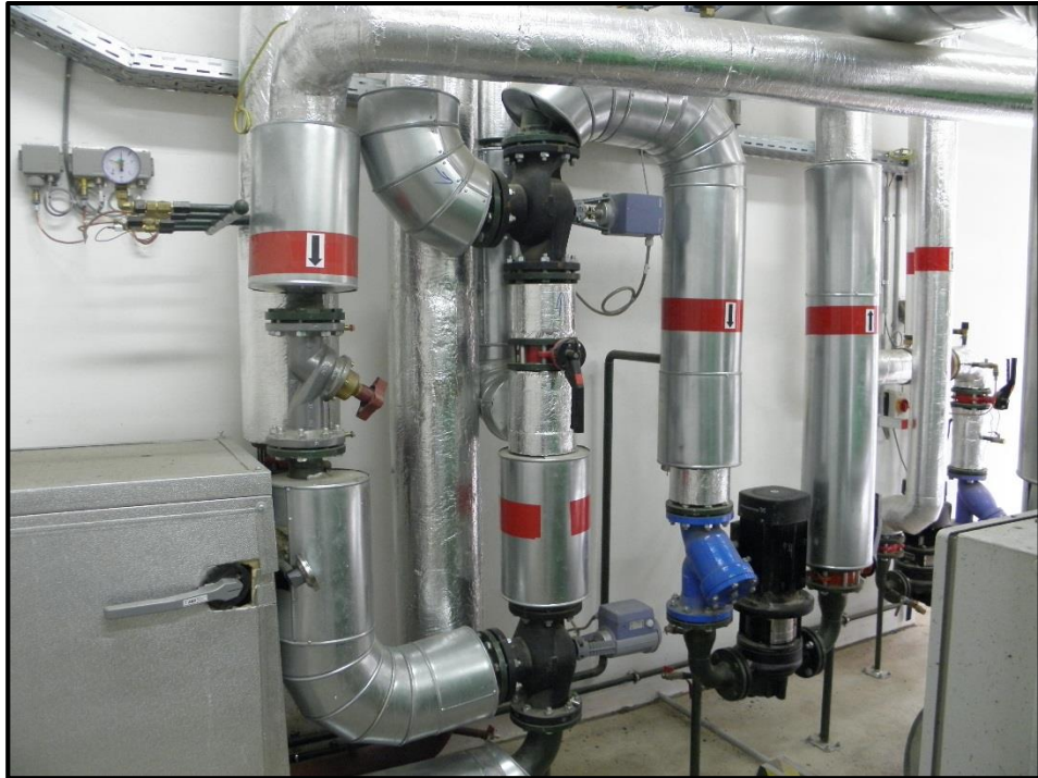
Obr. č. 29 – Příslušenství kogenerační jednotky – rozvody chladící vody (zdroj: Lucie Frank Kristová 29. 3. 2016)
