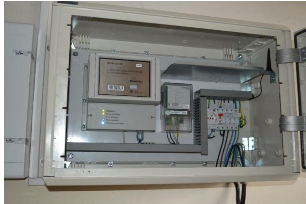
Obrázek 2 - Technologie v tzv. smart house na sídlišti Liščí kopec
