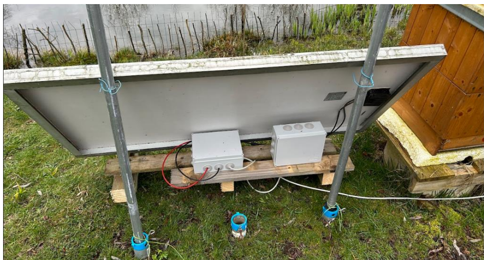
Obrázek 58 Uložení baterie a solárního regulátoru (vlastní)
