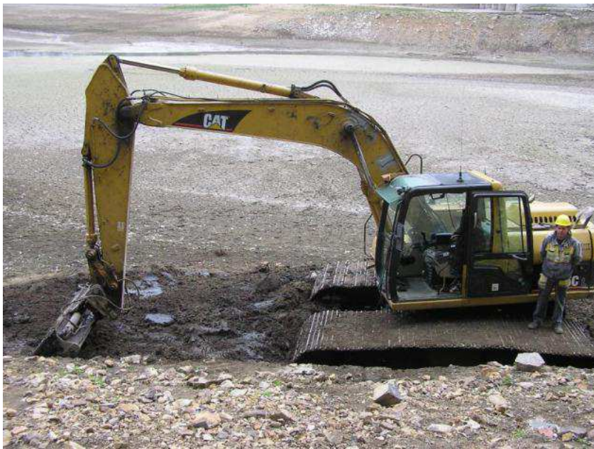
Obr. č. 30 - Širokopásový bagr při odbahňování prostoru kolem hráze VD Hostivař (Kefurt, 27.04.2011).
