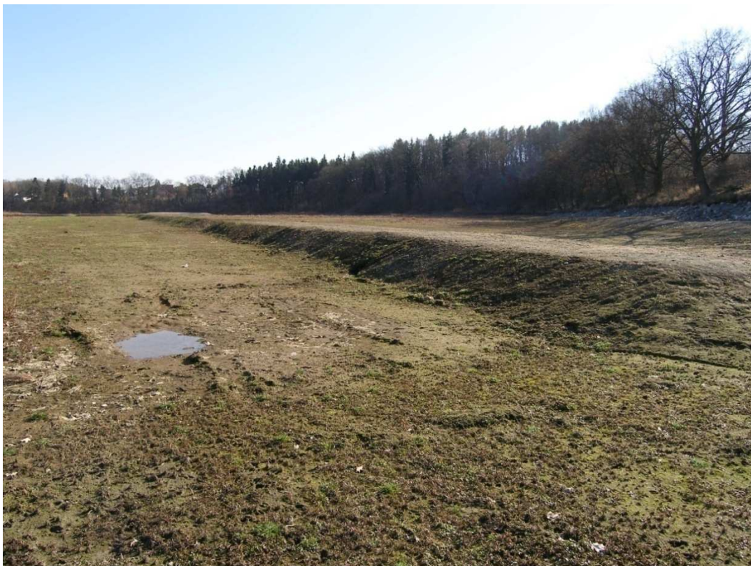
Obr. č. 28 - Provizorní komunikace pro odvoz sedimentu na dně nádrže (autor práce, 20.03.2012).
